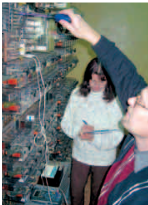
Regulace kolejového obvodu.
