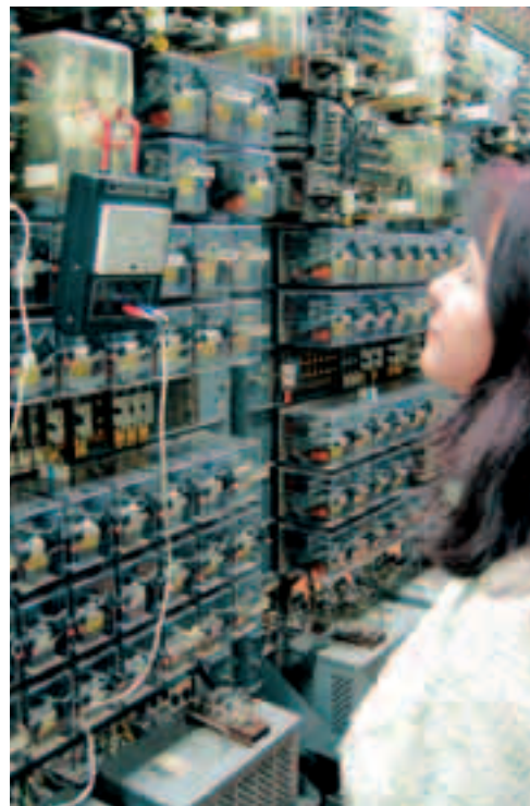
Kontrola šuntové citlivosti.
