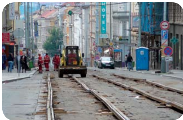
Již 16 hodin po zahájení výluky byly vytrhány, rozpáleny a odvezeny téměř všechny kolejnice.
