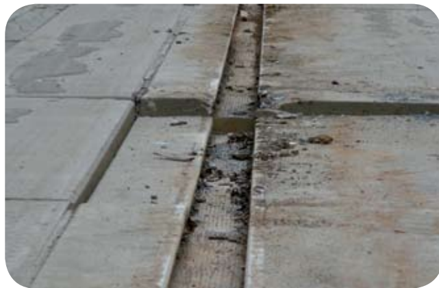
Propadlý panel u zastávky Lipanská, důvod zákazu vjezdu vozů 14T.
