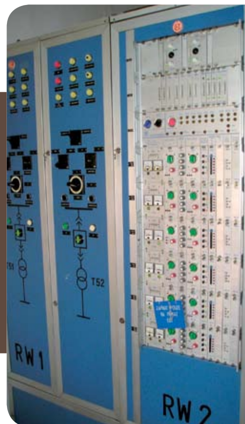
Původní řídicí skříň RW2, která je po revitalizaci nahrazena moderní technologií a na revitalizovaných měnírnách se již nenachází.
