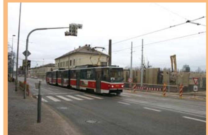
↑ Při jízdě tramvají o týden později už byla demolice montovny prakticky dokončena.
