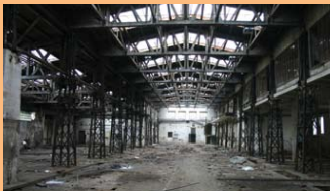
↑ Pohled do stejných míst 4. října 2007, když už byla montovna připravena k demolici a marně odolávala nájezdům sběračů kovů.
