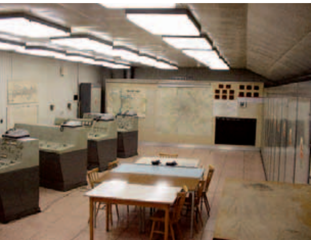
Řídicí centrum technického centra. Nadřazené tomuto pracovišti bylo centrální řídicí pracoviště. V případě potřeby bylo možné stanici řídit samostatně ze staničního řídicího pracoviště.
