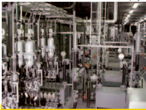
Část zařízení na výrobu a úpravu vody.
