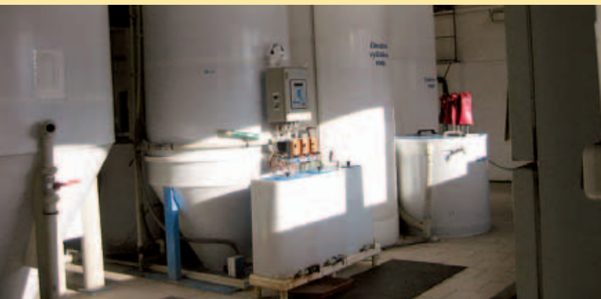
Čistírna odpadních vod Alfa v Opravně tramvají v Hostivaři.
