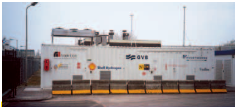
Stanice výroby vodíku.
