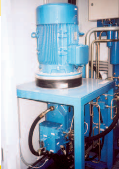
Pohled do kompresorové stanice.
