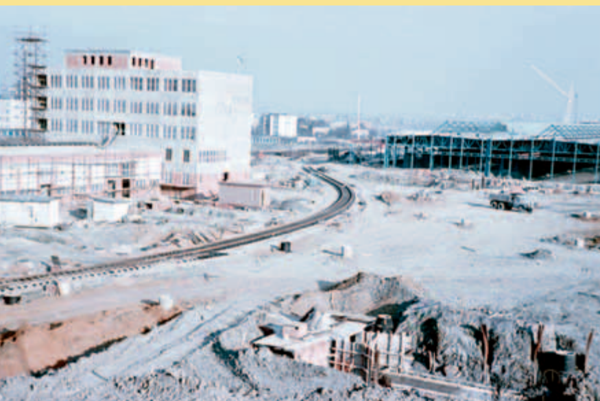
Fotografie rozestavěného depa se zárodkem budoucího ústředního stavědla z 29. listopadu 1972 s kolejovým propojením vlečky a metra.
