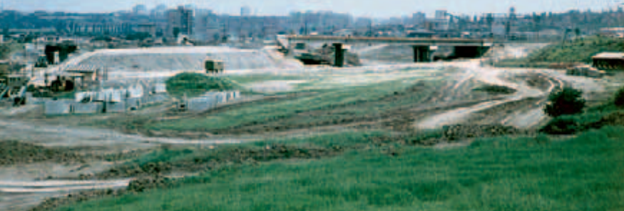
Pohled zpoza zářezu železniční tratě s vlečkou směrem k depu 10. července 1970. Na snímku je rozestavěný most dálnice (či přesněji – v tomto úseku již severojižní magistrály) přes budoucí povrchovou spojku do depa.
