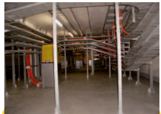
V nejnižší části jsou kabelové prostory s odpínači.
