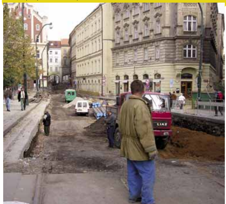
Trať u Karlových lázní po snesení původního tramvajového tělesa a zahájení prací na inženýrských sítích - 3. října 2002. Foto: Miroslav Penc
