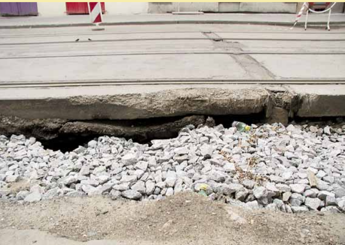
Foto č. 1: Poškození tratě poblíž Negrelliho viaduktu po havárii kanalizace (9. 7. 2001).
