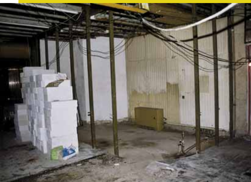
Takto měsíc před otevřením vypadá stanoviště pracovníka u vstupu do stanice Můstek na trati B. Čeká ještě mnoho práce.
