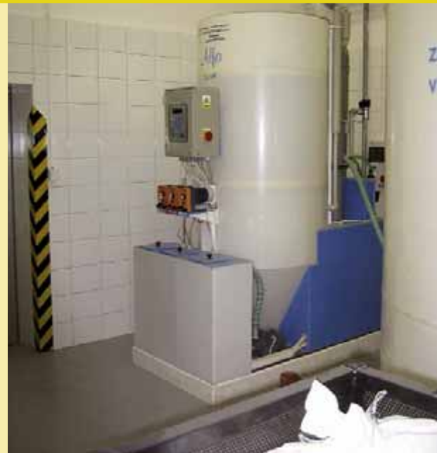
Nová čistírna odpadních vod (ČOV) Alfa 2,2 v ÚD Hostivař.
