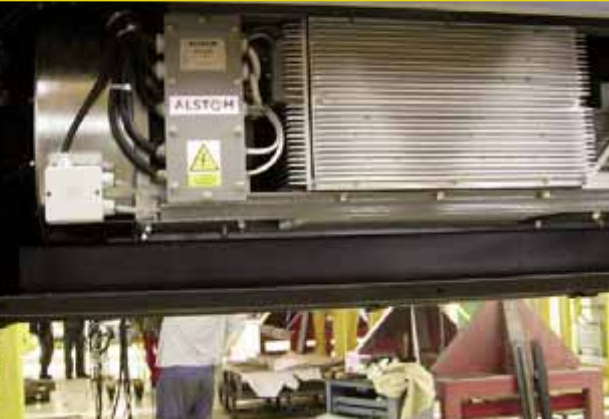
Zavěšení statického měniče.
