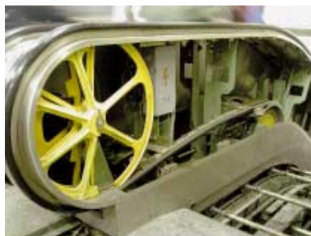
Pohled na poháněcí kolo madla a vedení madla v horním nástupu pohyblivých schodů.
