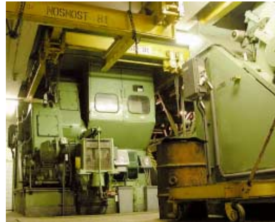
Pohled na pohon pohyblivých schodů typu ET.
